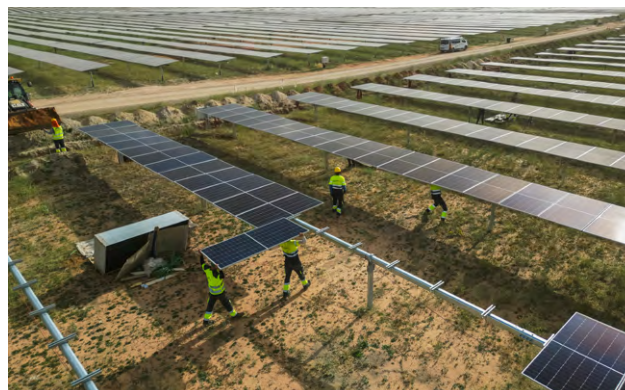
Seit 2024 in Betrieb: die PV-Anlage Picón
