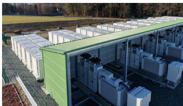
BESS Wunsiedel: In Betrieb seit der zweiten Jahreshälfte 2025
